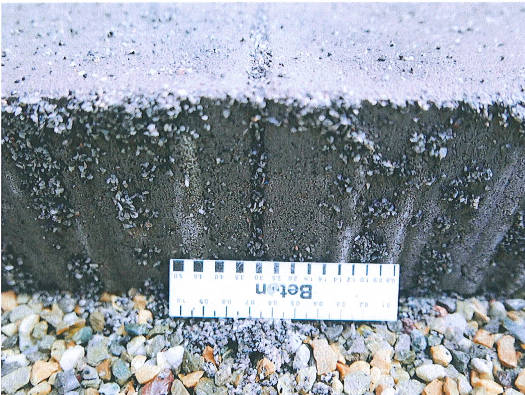
Bild 5: Detailansicht, Fuge nach Bewässerung.
