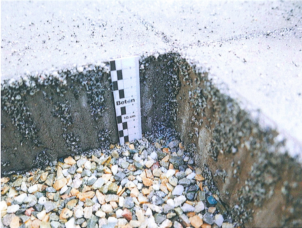
Bild 5: Detailansicht, Fuge nach Bewässerung.
